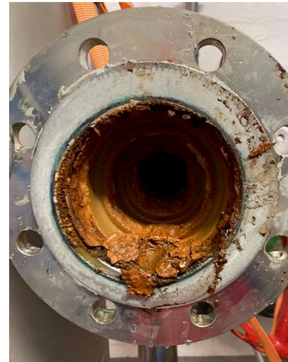
Dieses Foto zeigt Rostablagerungen, bei Installation deren Erdung nicht entsprechend der Empfehlung ausgeführt wurde
